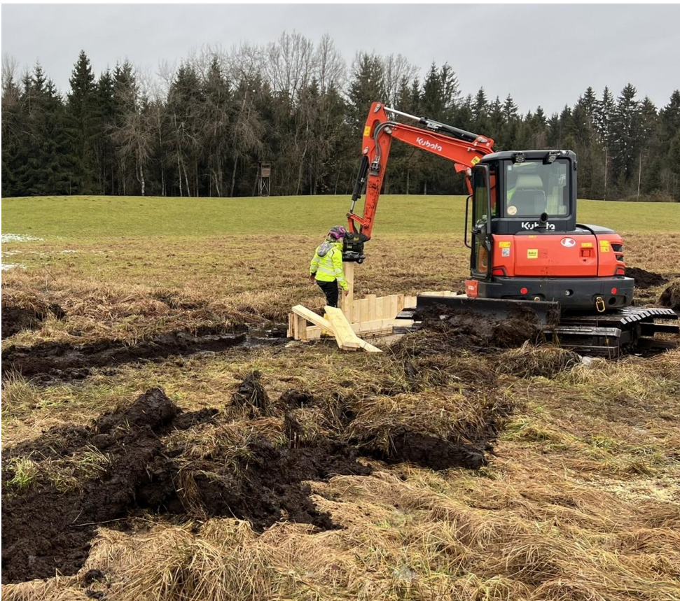
Mit speziellen Moorbaggern und doppelten Nut-/Feder-Brettern wird eine Holzspundwand in den Entwässerungsgraben gebaut, die das abfließende Wasser im Moor zurückhalten soll. © LPV Lindau
